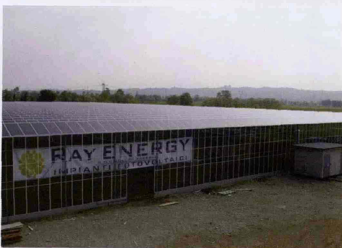
La più grande serra fotovoltaica d'Italia realizzata nella provincia di Brescia nelle campagne di Esenta di Lonato.
