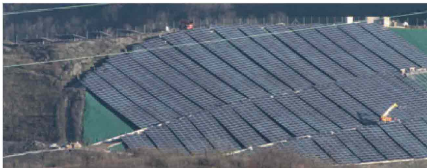
PRIMA DI COLLOCARE I MODULI SUL FIANCO DELLA COLLINA, PROJECT GROUP SI È OCCUPATA DELLA REALIZZAZIONE DELLE VIE DI ACCESSO PER I MACCHINARI
