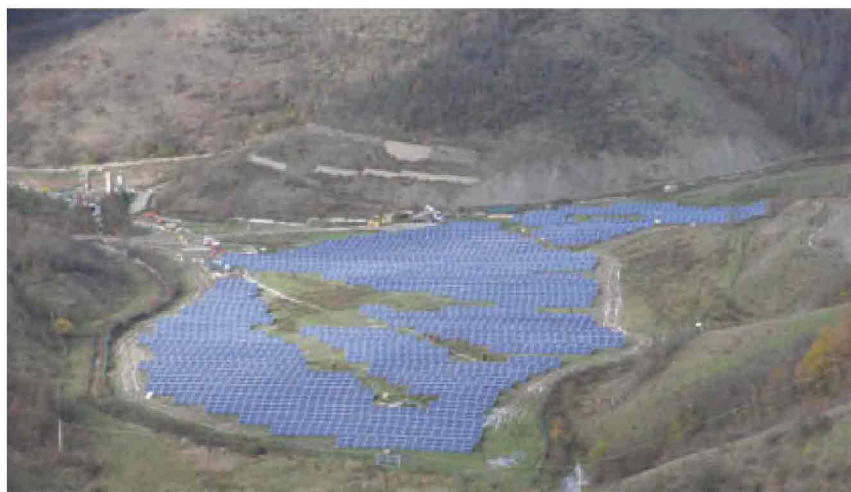
L'IMPIANTO INSTALLATO NEL FONDOVALLE UTILIZZA 4.158 MODULI UPSOLAR UP-M240P E 33 INVERTER POWER-ONE
